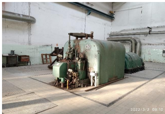
Turbosoustrojí o výkonu 4 MWe
